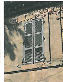
Exemple d'enduit arrêté par l'encadrement saillant de la fenêtre
