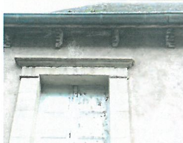
Exemple de corniche dont le lattis a été déposé (la trace des lattis se lit encore sur les consoles en bois).
