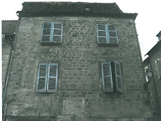
Exemple de maisons conservant des maçonneries appareillées et des éléments de décors (cordon mouluré, jambages de baie géminées) du XIII e siècle.
